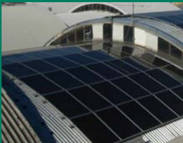
installazione su tetto - copertura curva
